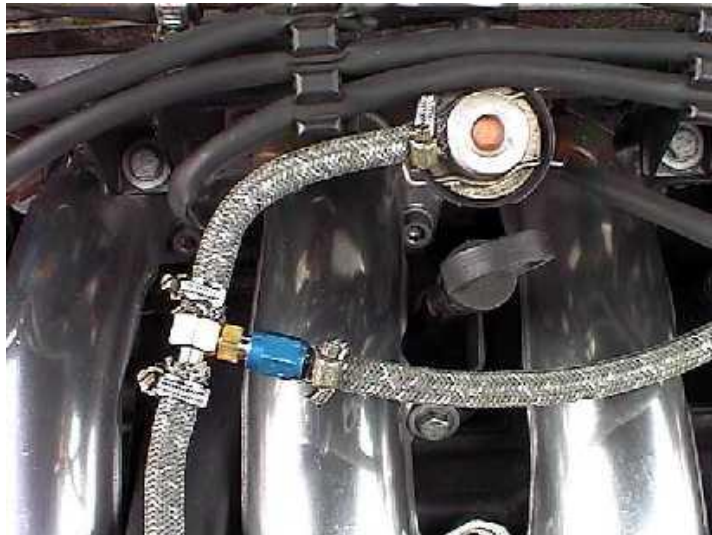
les électrovannes et les tuyaux d'essence
